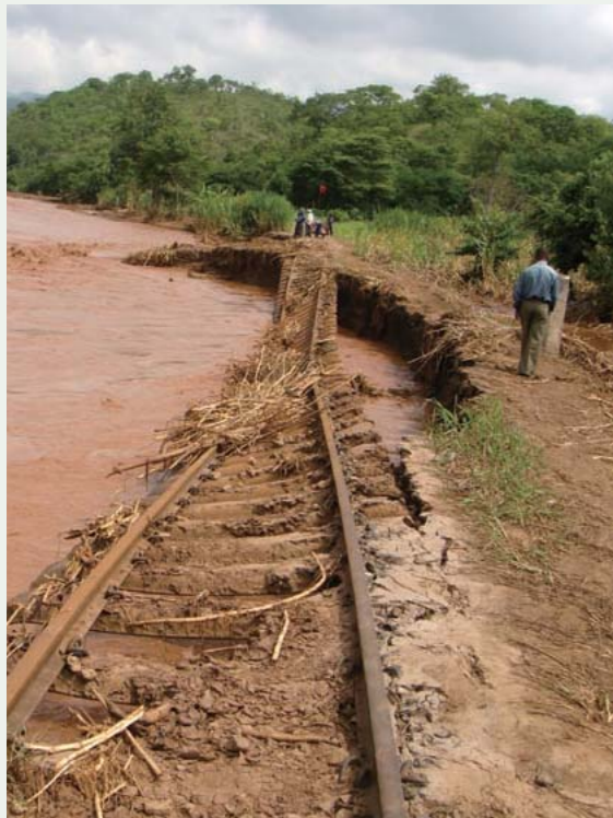
川の流れが変わったため、足元が完全にえぐられてしまった線路。大きな移設で再発を防ぐ予定だ
